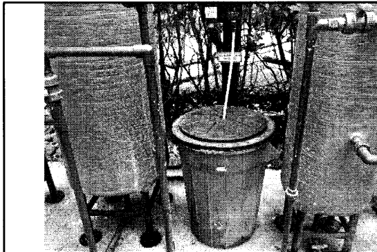
Foto No. 7. Dosificador de cloro
